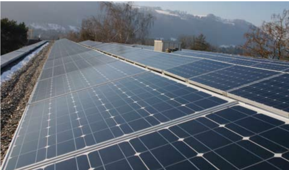
Photovoltaik-Zellen wandeln die Strahlen der Sonne direkt in Strom um.
